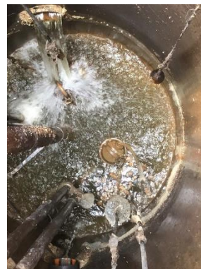
Helt klart indløbsvand i pumpestation ved Solbakkevej i Dronningmølle
